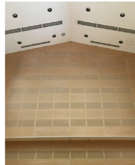
ホールの壁面一面に貼られた音響調整板
